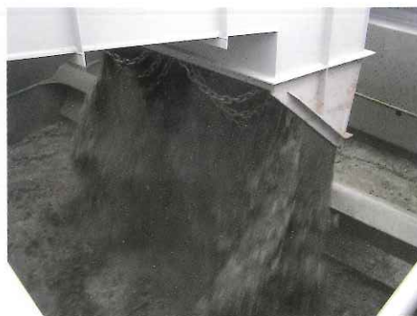
トラフ（泥積込口）
