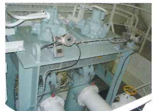
油水吸引ポンプ
